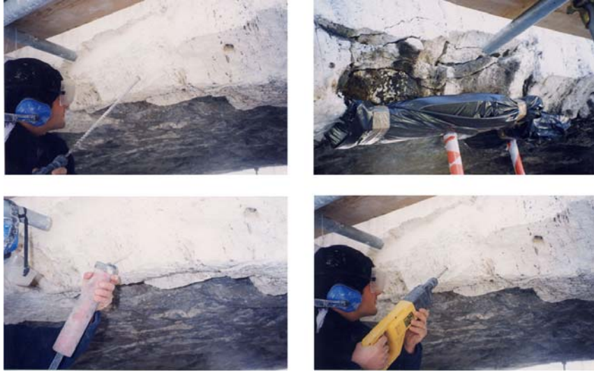
شكل رقم(3): خطوات تدعيم الاجزاء الحجرية الاليلة للسقوط: 1.تدعيمها بالجكات 2. ثقبها بالمقذح تمهيدا لادخال القضيب الحديدي الذي سيعمل على تماسك هذا الجزء مع الاجزاء الثابتة في السقف. (Docci, 2005)
