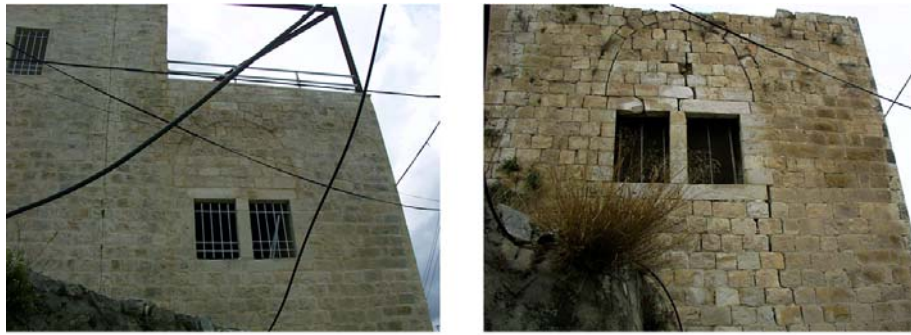
شكل رقم(21.5): تصدعت الواجهه الغربيه قبل وبعد الترميم(ظاهر 2007، بحث غير منشور)
