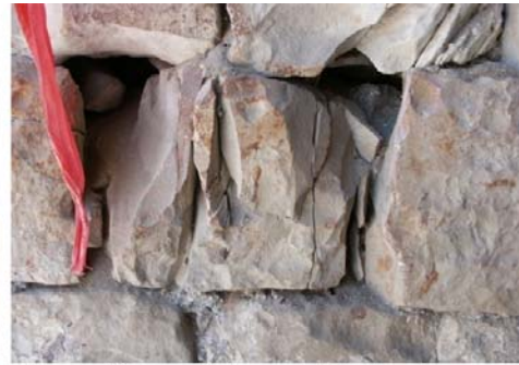
مجموعة من الحجارة في احد جدران المبنى وقد تآكلت وحصل فيها تهشيم كبير وقد وجب تدعيمها او استبدالها
